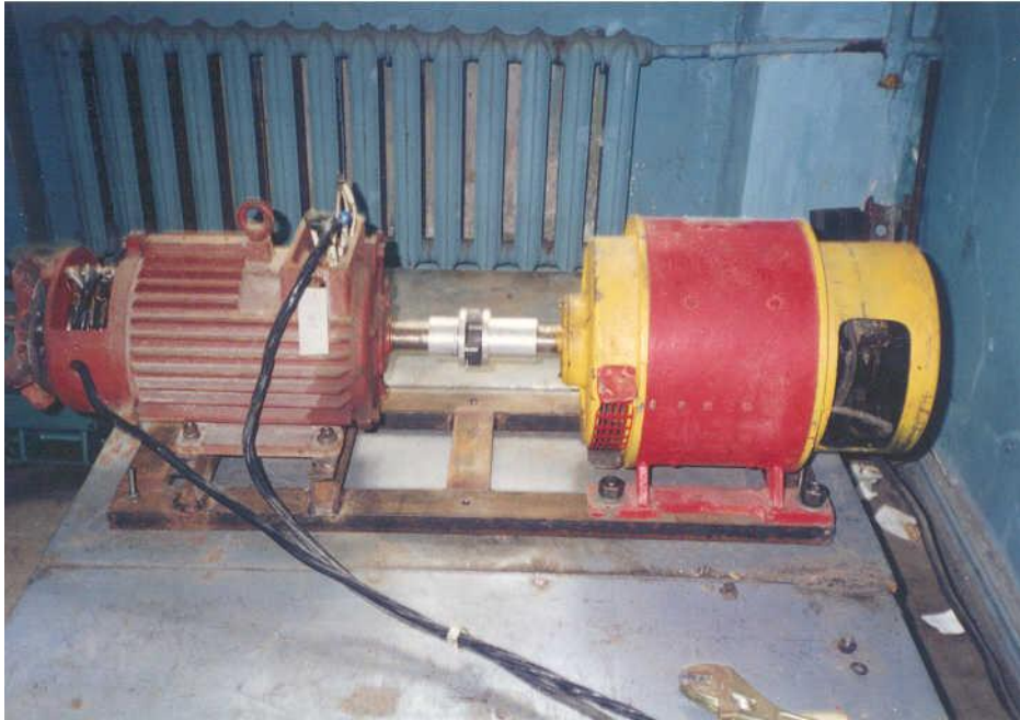
Рис. П.4. Генератор на базе двигателя АОК-51-6
